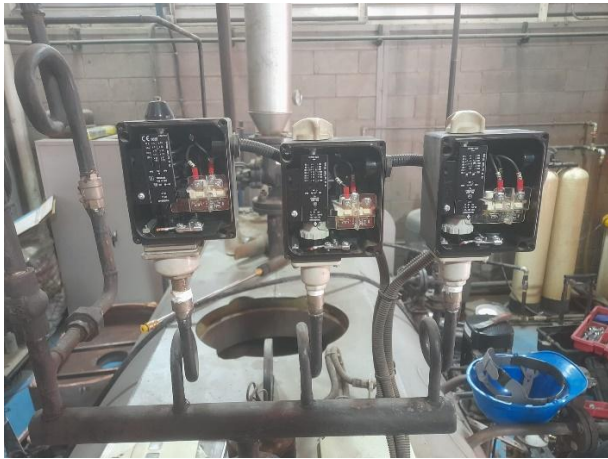
SISTEMA DE TRATAMIENTO DE AGUA CALDERA DE VAPOR
