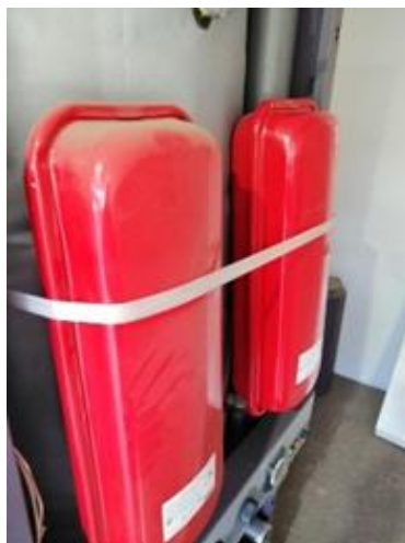
ESTANQUES DE EXPANSION
