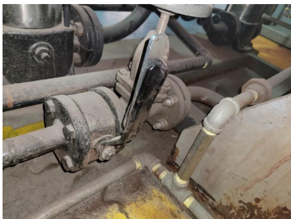
PURGAS DE AGUA Y LODOS DE LA CALDERA DE VAPOR
